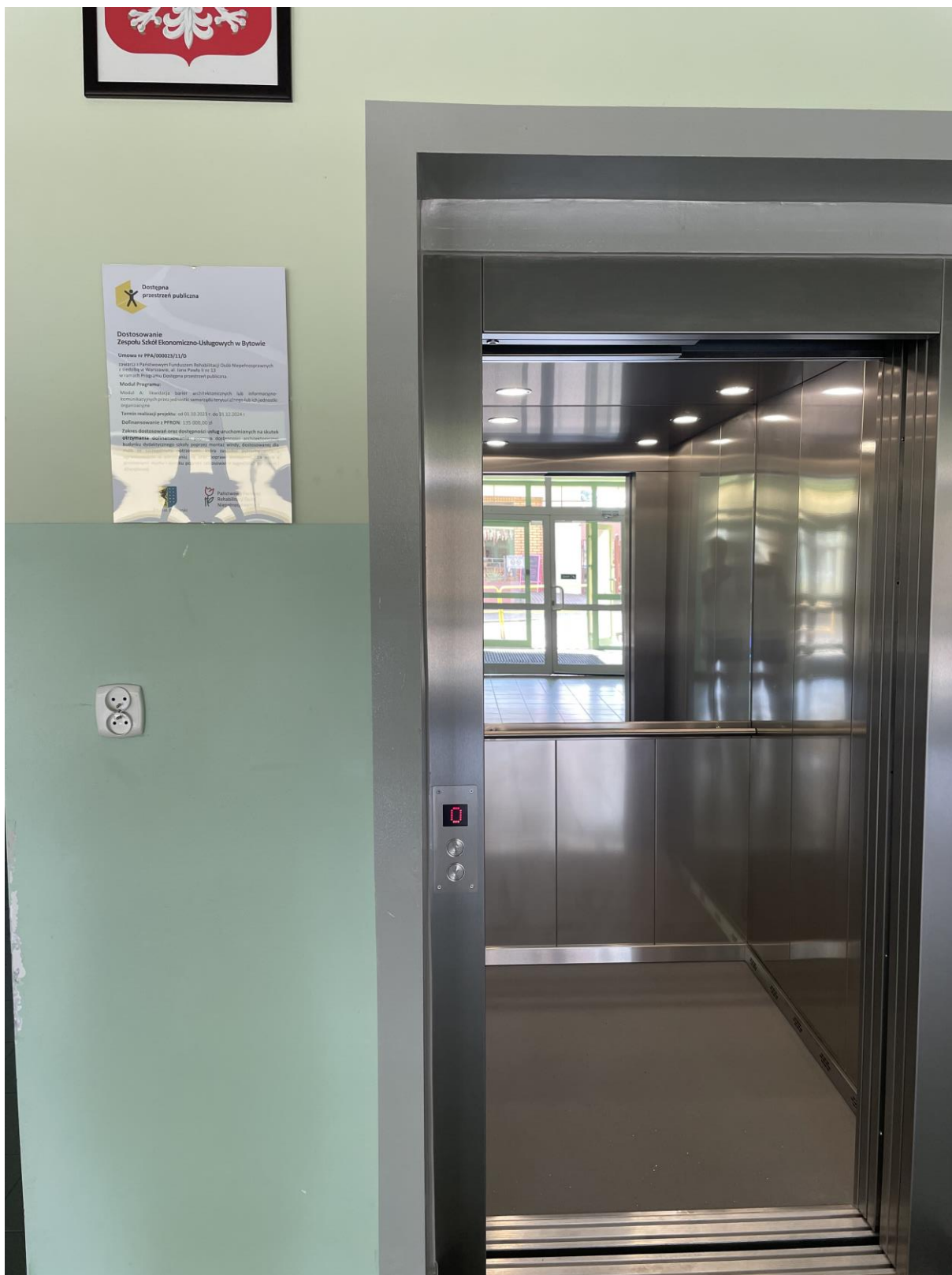
Fot. 5. Zmodernizowana winda w budynku szkolnym ZSEU w Bytowie
